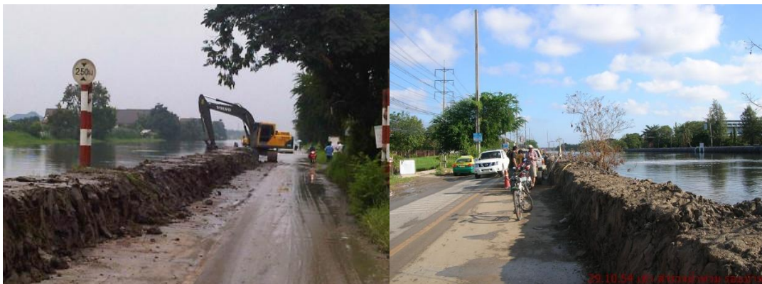
ภาพที่ 2 การสร้างคันกันน้ำ เพื่อป้องกันน้ำท่วมพื้นที่ชุมชน
